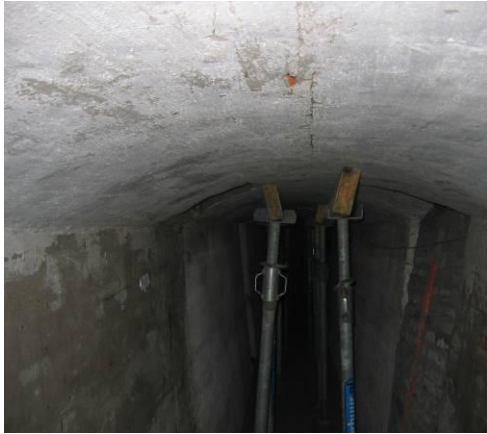
Figuur 39: Een scheur in het plafond van een gangenstelsel.
